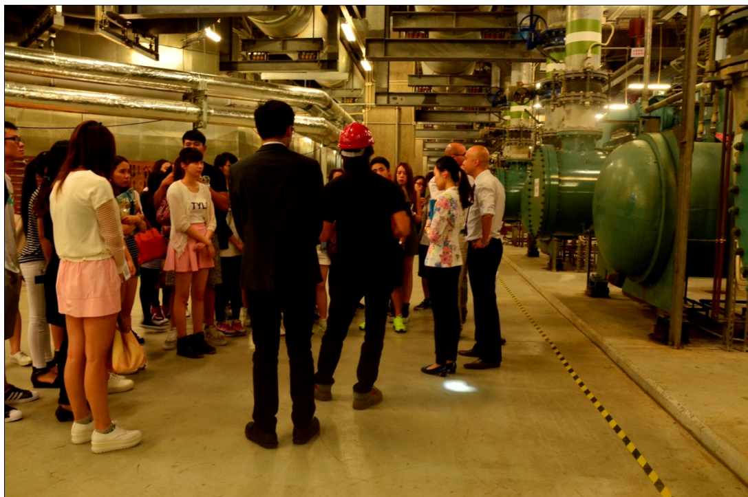
P004：工程部員工向學生介紹減低空調能源消耗的中央制冷主机房。
